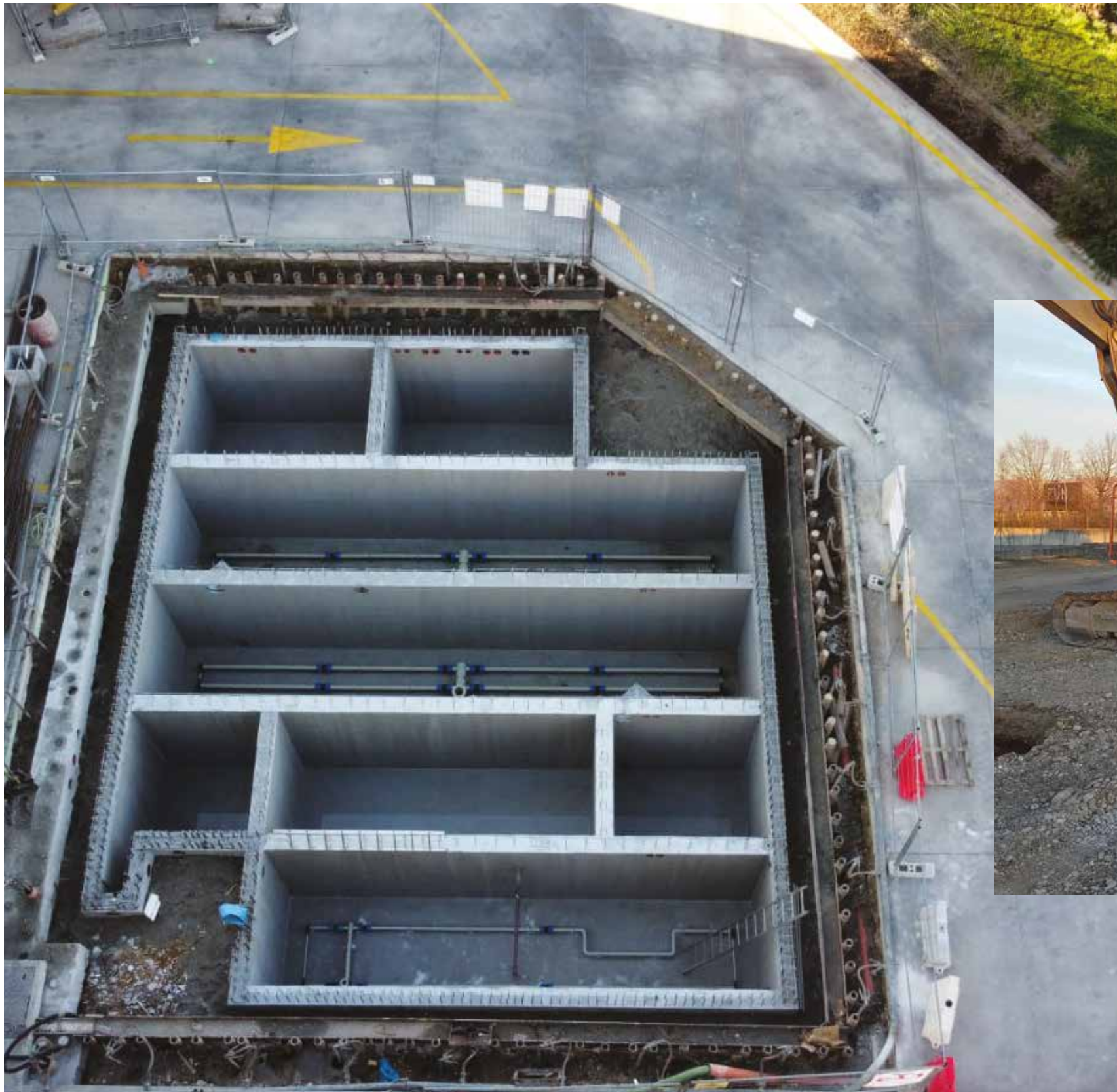
← Impianto di depurazione
